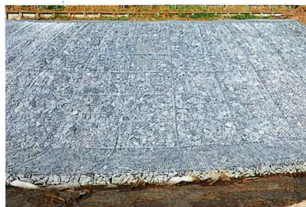
国土交通省関東地方整備局江戸川河川事務所 地金堀樋管新設及び築堤護岸工事
